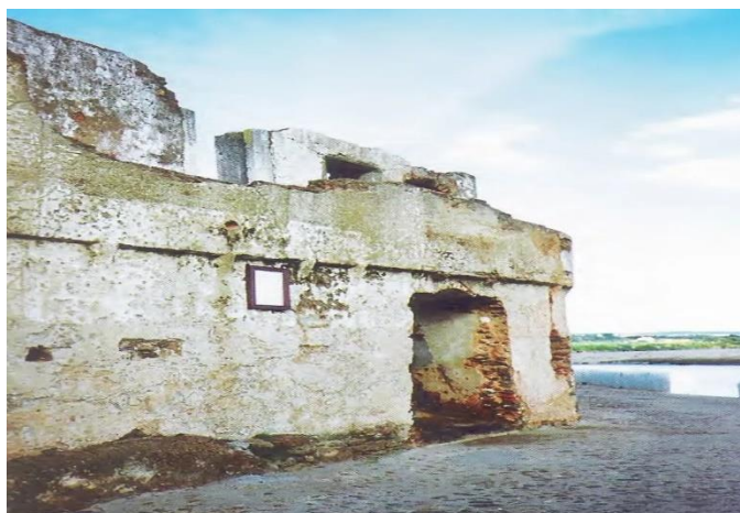
Figura 26-A Casa dos Arcos em Constância completamente ruína
